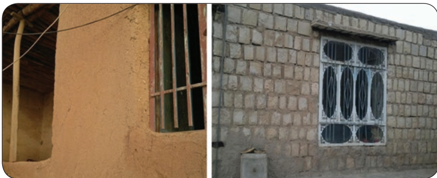
تصویر شماره (۴): استفاده از سنگ و کاه گل در بناهای مسکونی روستای هلسم (نگارنگان، ۱۳۹۳)
